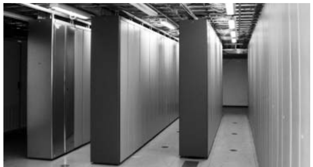
Abb. 37. In klimatisierten Räumen, gut verschlossen und fast „klinisch rein“: die digitale Vermittlungsstelle Krefeld an der Moerser Straße 7.
