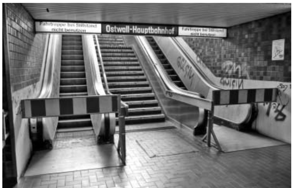
Abb. 3. Ein desolates Bild: Der Stadt fehlt das Geld für die Reparatur der Rolltreppen in den Unterführungen an Rheinstraße und St.-Anton-Straße.
