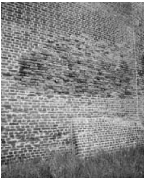
Abb. 10. Geschädigtes Mauerwerk ohne Restauration
